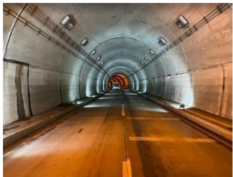
▼トンネル内 仮設照明
